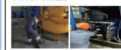
石化公司动力车间 成晓
